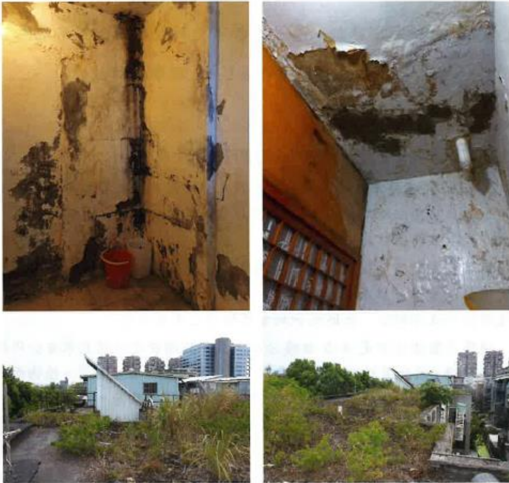
圖1 民生社區步登公寓住宅室內漏水、屋頂植被影響排水議題
